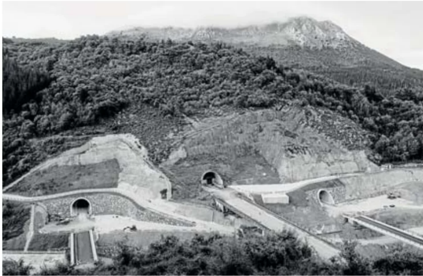
Túneles, viales y plataformas en las obras del proyecto del Tren de Alta Velocidad. JON GARATE
